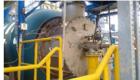
60-тонный одинарный водотрубный котел, работающий с 2 видами топлива. Мощность горелки: 55 мВт
